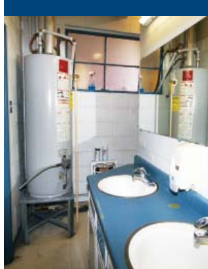
Baños/Duchas de la Estación de Bomberos
